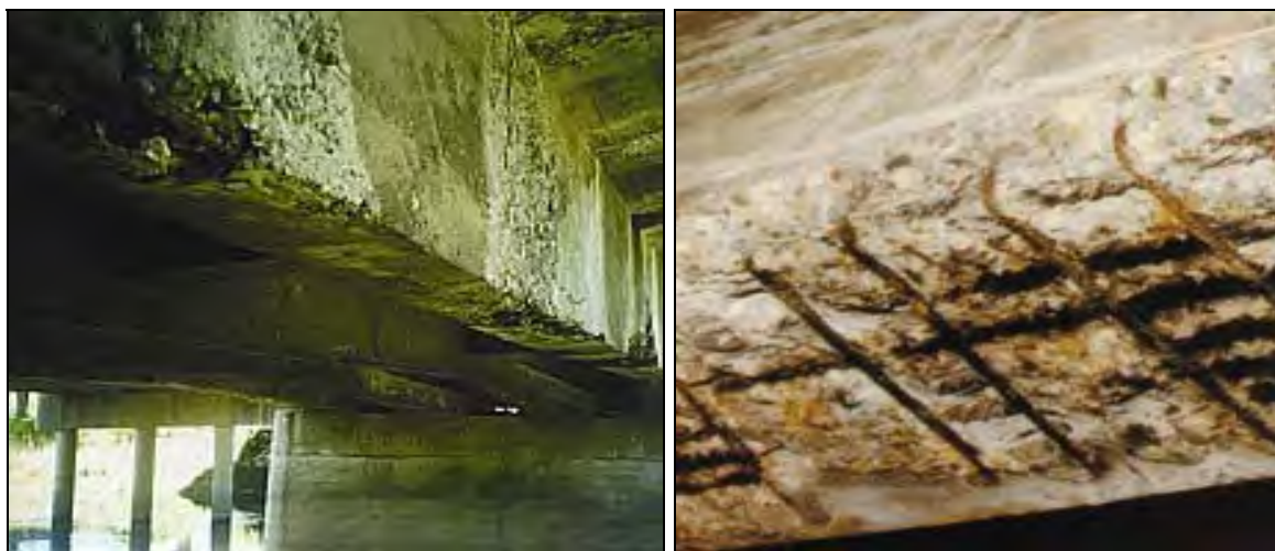
شکل ۲-۴-۱- نمونه‌هایی از آسیب دیدگی تیرهای بتنی
