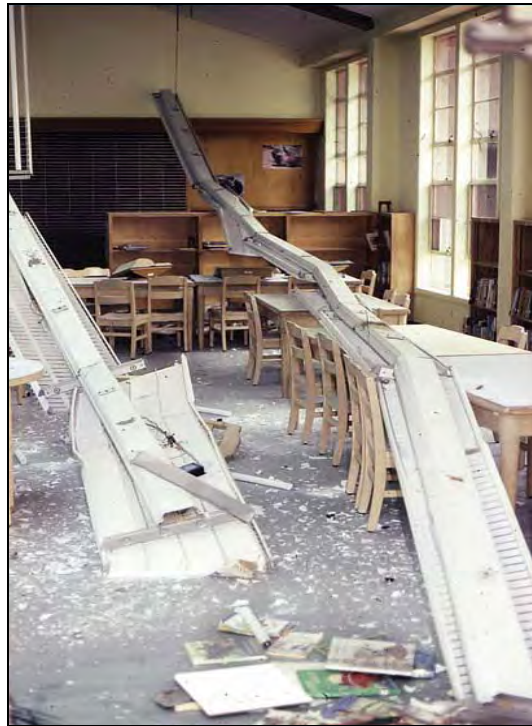
شکل ۱۰-۲- آسیب به سیستم روشنایی در هنگام زلزله
