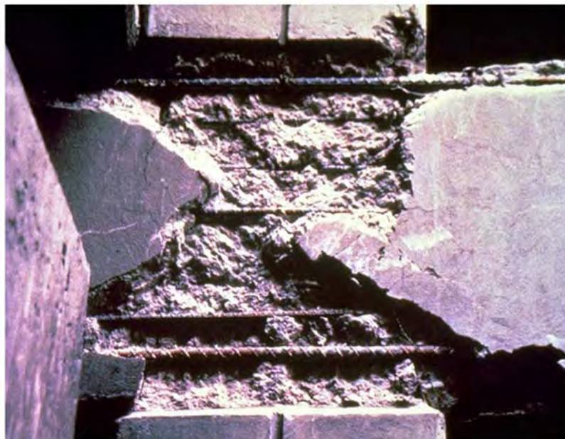
شکل ۸-۶-۲ کمانش میلگردهای طولی تیر در ناحیه اتصال
